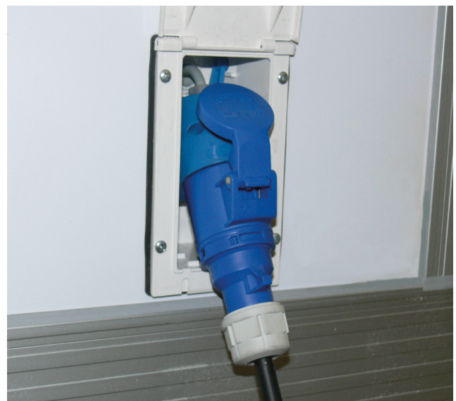
Einspeisesteckdose CEE 230 V / 16 A außen
