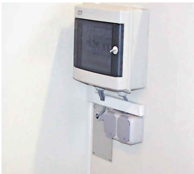
Verteilerkasten mit FI und Sicherungen
