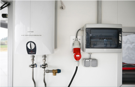
5 l Warmwasserboiler und Verteilerkasten mit 400 V-Steckdose und 230 V-Doppelsteckdose
